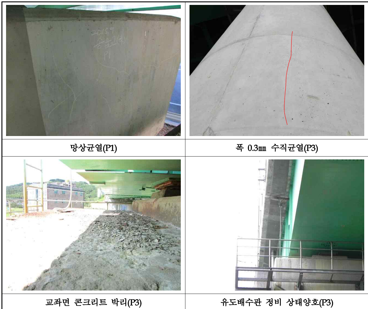
【사진 3.3.8】 교각 손상현황(부산)
