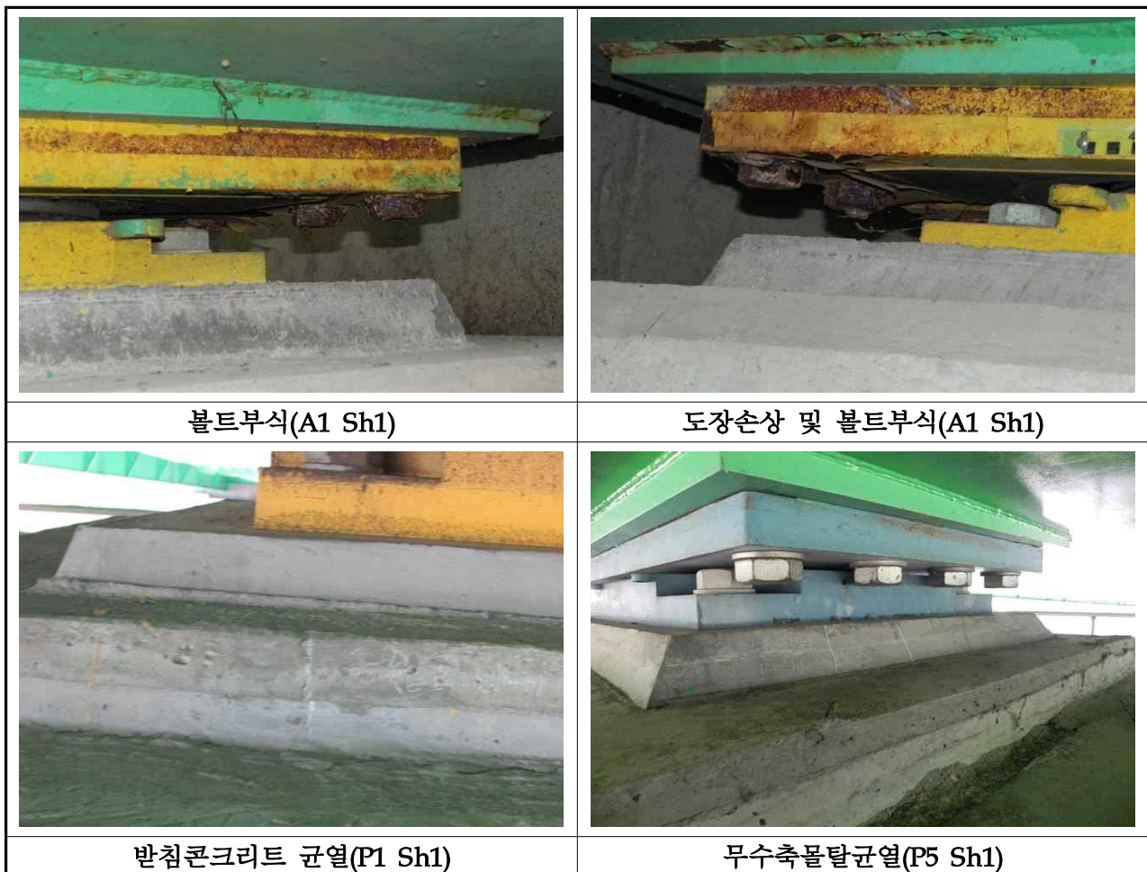
【사진 3.2.10】 교량받침 손상현황(대구)
