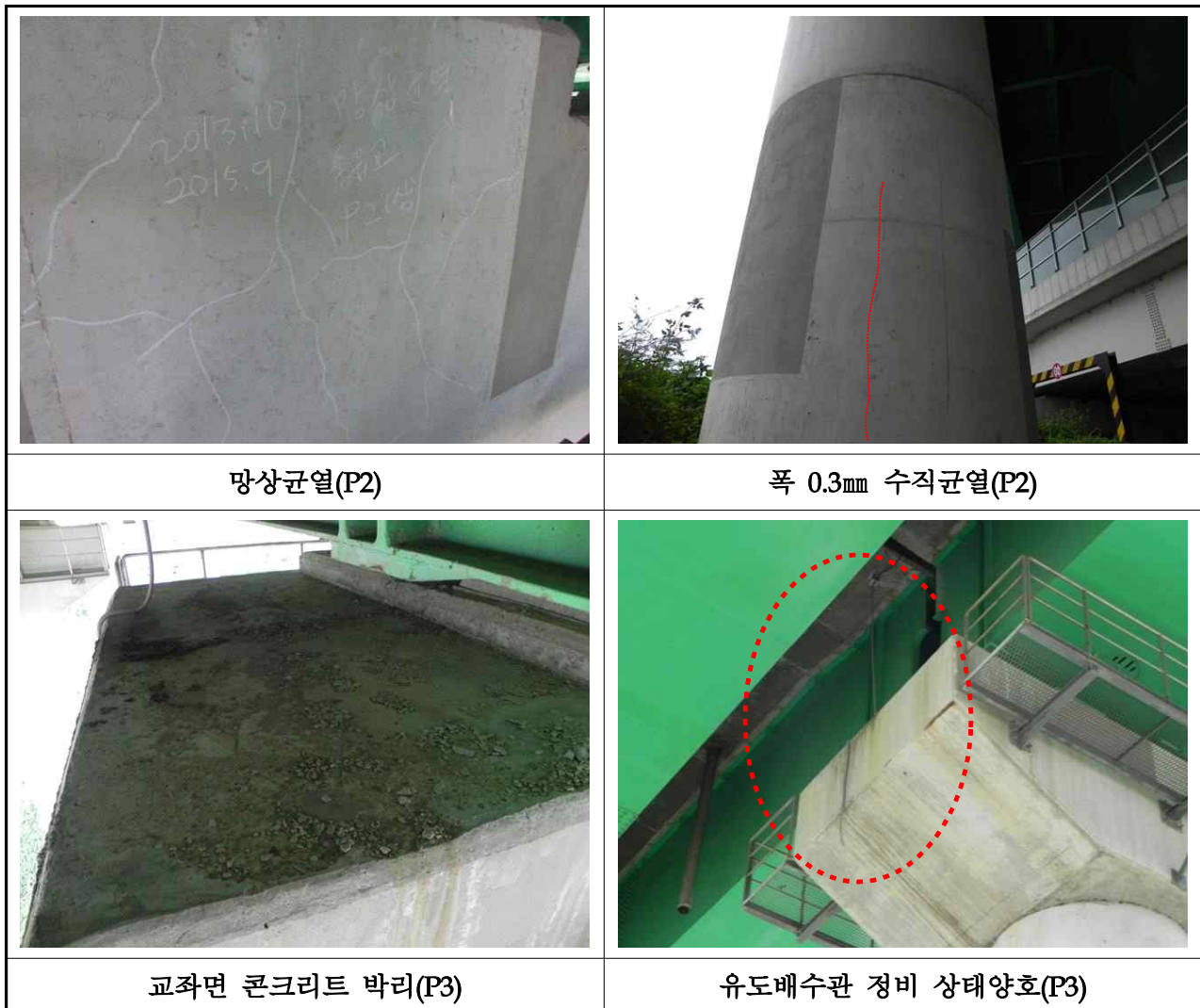
【사진 3.2.8】 교각 손상현황(대구)
