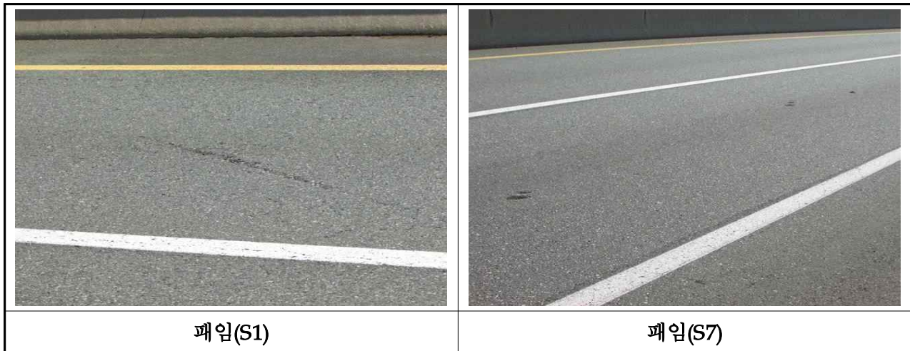
【사진 3.3.16】 교면포장 손상현황(부산)
